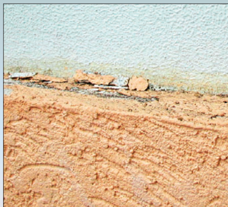
Верхняя кромка архитектурного элемента выполнена с уклоном в сторону основания, что привело к накоплению снега и разрушению отделочного слоя
