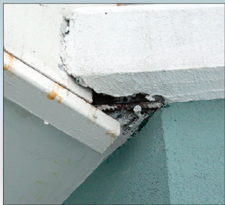
Процесс коррозии металлических закладных и несущих элементов
