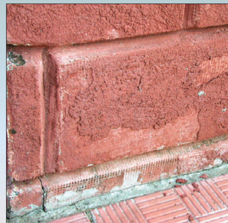
Разрушения отделочного слоя в цокольной части здания вследствие неправильного выбора материалов
