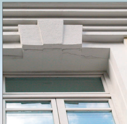
Трещины на границе архитектурных элементов с последующей передачей напряжений на армированный слой
