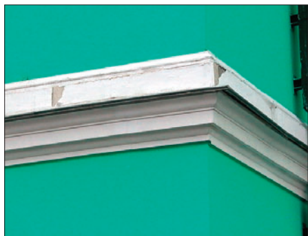
Разрушение архитектурных элементов из-за отсутствия покрытия и нарушений в процессе армирования и защиты примыканий
