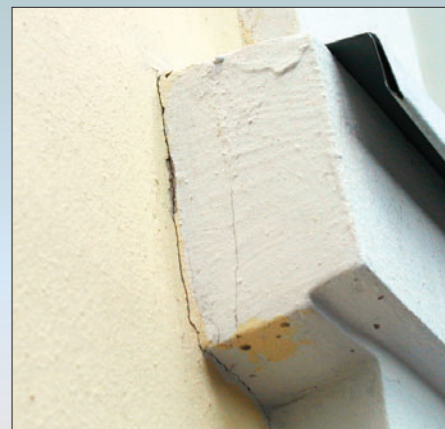
Разрешения в местах примыкания архитектурных элементов. Установленный отлив не укрывает всю поверхность
