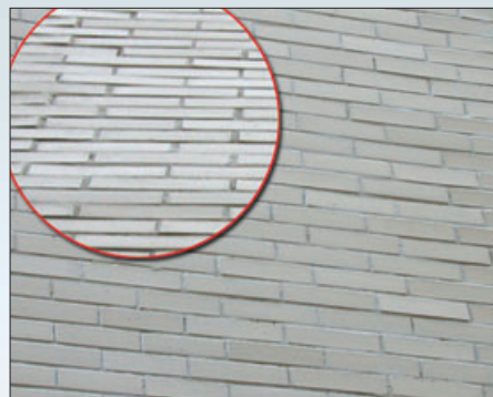
Отслаивание или обрушение отдельных участков декоративного покрытия клинкерной плиткой из-за применения плитки с избыточным весом, неправильного расчета влагопереноса или применения несоответствующих клеевых составов
