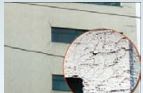
Трещины по углам проемов из-за неправильно произведенного монтажа плит теплоизоляции (нет необходимого технологического выреза плиты, грани плит повторяют линию горизонтального или вертикального откоса проема), а также отсутствия дополнительных усиливающих диагональных «косынок» армирующей сетки.
