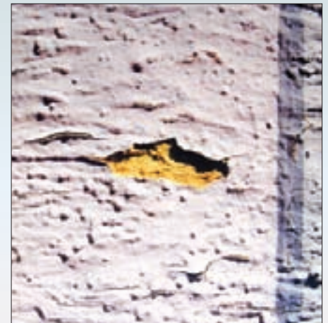
В процессе монтажа не была установлена армирующая сетка.
