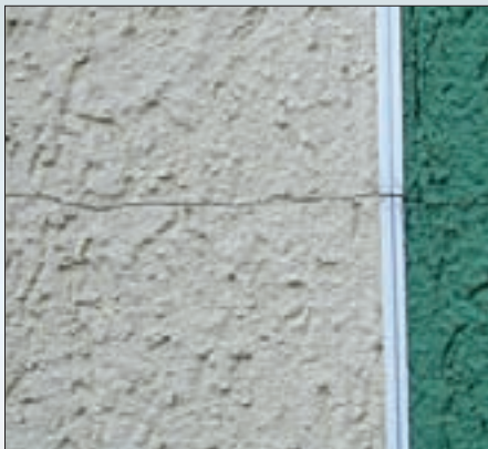
Произошла деформация теплоизоляционных плит в центре или по краям вследствие несоблюдения технологии нанесения клеевого состава и дюбельного крепления.
