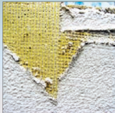
Трещины и разрушения армирующего слоя при производстве армирования с помощью декоративной штукатурки вследствие невыполнения перехлеста стеклотканевых сеток.
