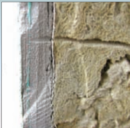
Растрескивание и расслоение армирующего слоя вследствие нарушения технологии нанесения (толщина армирующего слоя превышает допустимые показатели, сетка установлена на теплоизоляционной плите).
