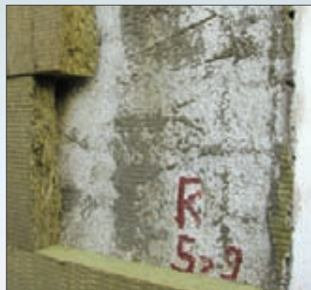
Приклеивание теплоизоляционных плит велось с использованием некачественных и/или непредназначенных для монтажа клеевых составов.
