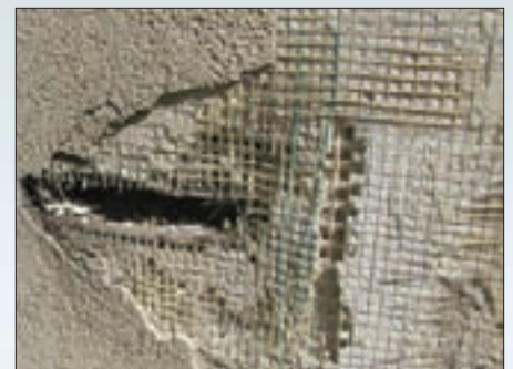
Растрескивание и расслоение армирующего слоя по его толщине вследствие нарушения технологического процесса нанесения (после монтажа сетки произошло высыхание первого слоя, последующее шпаклевание проводилось по образовавшейся полимерцементной пленке).
