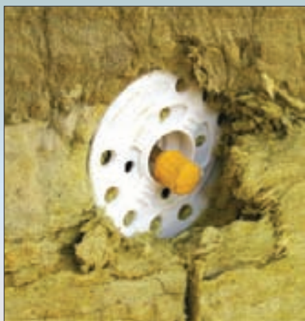
Нарушение технологии и несоблюдение технологических требований привело к установке дюбелей с перекосом и излишним заглублением.
