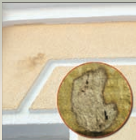
Темные пятна на декоративном слое вследствие выхода из минераловатных плит большого количества связующего через армирующие и отделочные слои
