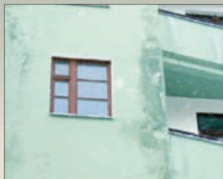
Произошло разрушение и последующие отслоения декоративного покрытия при применении минераловатных плит с повышенной влажностью. Намокание теплоизоляционных плит произошло из-за неправильного хранения материалов и/или длительного нахождения смонтированных плит на фасаде здания без устройства противоосадочного укрытия
