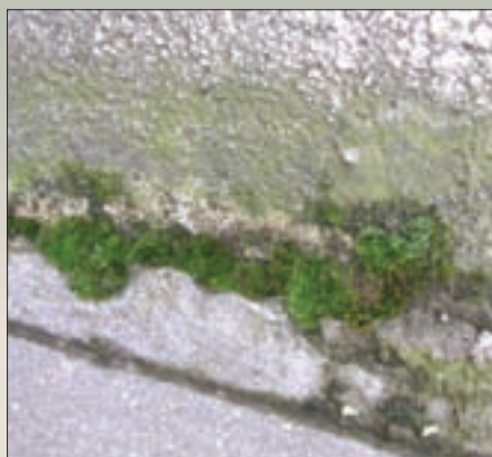
Заплесневение и разрушение отделочных покрытий с последующим ростом грибковых и мховых поражений вследствие неправильного выбора теплоизоляционной плиты и декоративно-защитных материалов в цокольной части здания
