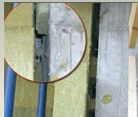
Монтаж теплоизоляционных плит велся на неподготовленное (загрунтованное) бетонное основание. Теплоизоляционные плиты устанавливались на подкладках, площадь которых составляет не более 20% от требуемой. Установка велась без использования клеевого крепления
